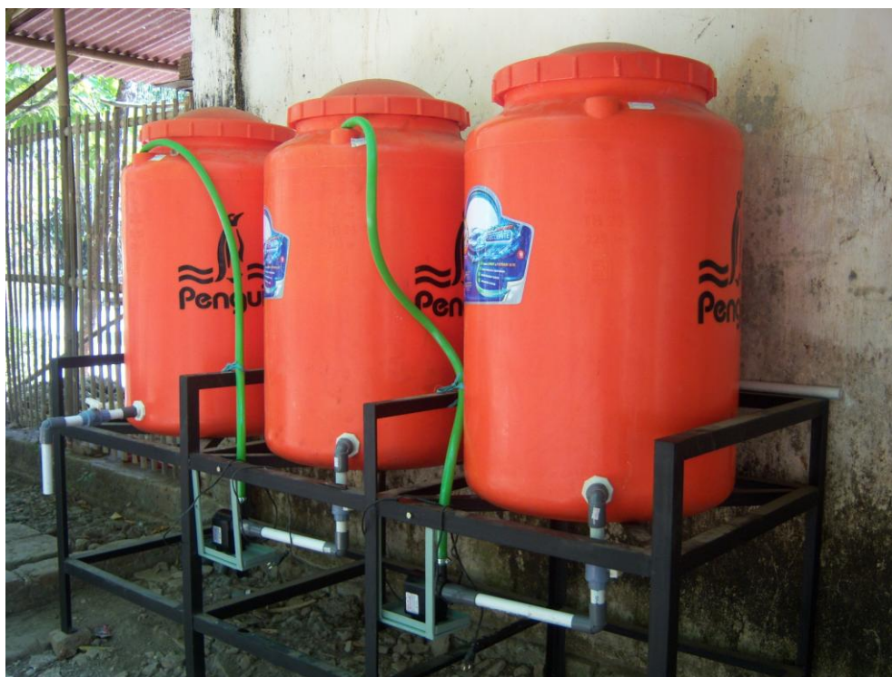
Gambar 3. Instalasi Pengolah Limbah
