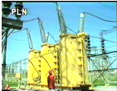
Gambar 1.4. Komponen saluran transmisi, transformator distribusi, peralatan rele pengaman dan pemutus rangkaian, kapasitor statis, dan reaktor paralel (gambar diambil dari dokumentasi PT. PLN).
