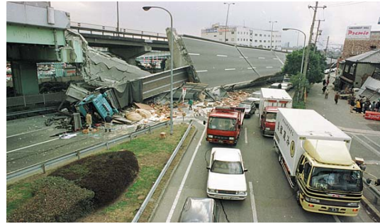
Gambar 3.1. Jalan layang yang patah akibat gerakan permukaan
