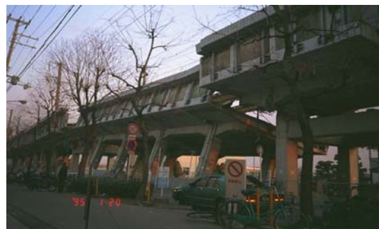
Gambar 3.2. Jalur kereta api patah akibat gerakan permukaan
