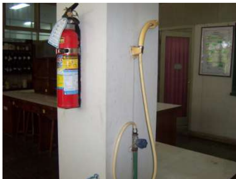
Gambar 4. Tabung pemadam kebakaran dan water shower.
